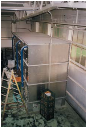
Mehlsilo mit Filtertuchabschluss
